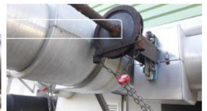
Vanne de bypass du dessablage-déshuilage
