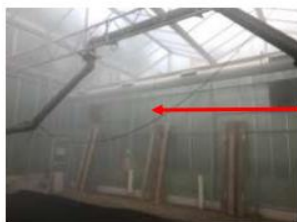
Condition 2 : Deux ventilateurs et désodorisation à l'arrêt
