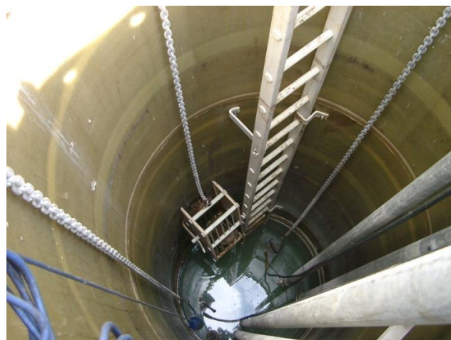
La fosse du poste de refoulement 147 à Arnières-sur-Iton
